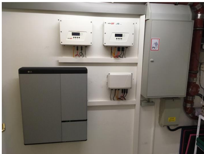
SolarEdge Optimierer+Hybrid-Wechselrichter plus LG-Batterie
