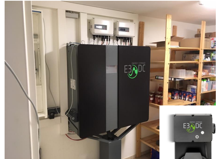
Innovatives E3DC Hauskraftwerk (inkl. Wechselrichter + Batterie+Leistungselektronik.)
